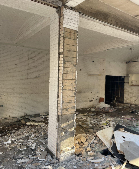
Kaplaması sökülen kolon: gerçek taşıyıcı kesit, kaplamalı halinden belirgin biçimde küçük.
